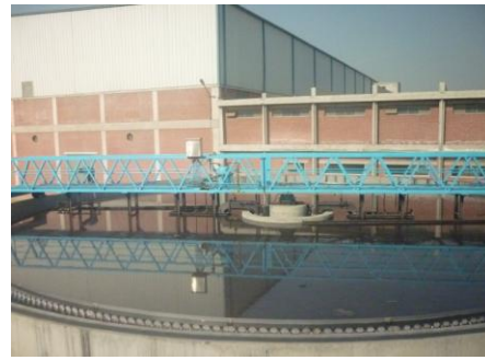
(d) Secondary Clarifier
